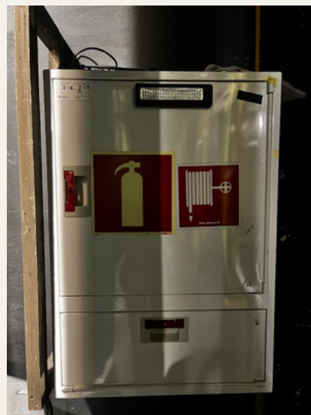
Paloposti ja vaahtosammutin sijaitsevat näyttämön oikealla puolella (yleisön näkökulmasta). Vaahtosammutin löytyy myös näyttämön vasemmalta puolelta.
