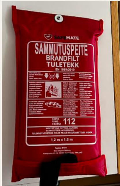
Keittiön sammutuspeite, kahvihuoneen ovien vieressä
