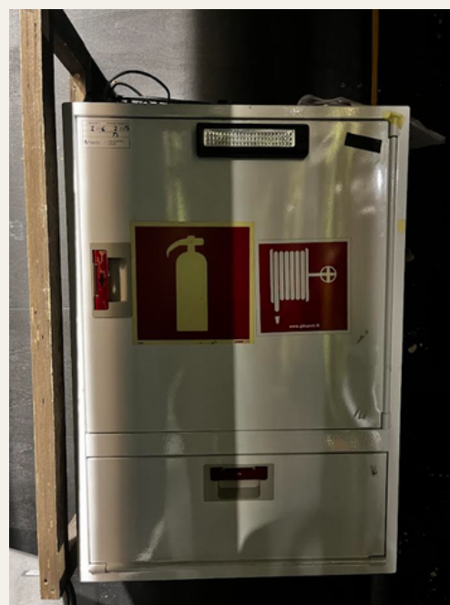
Brandslang och skumsläckare på högra sidan av scenen (publikens synvinkel). Skumsläckare finns även på vänstra sidan.
